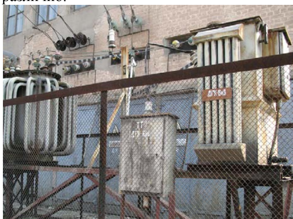
Рис.1. Установка системы компенсации I_c
